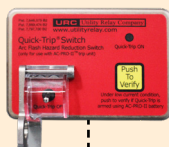
QT2-Switch auf Vorderseite der Schaltschranktür
